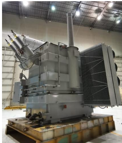
Fig. 3. Transformador de potencia monofásico del Caso 1.
