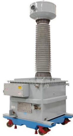
Fig. 11. Transformador de servicios propios del Caso 3 [12].
