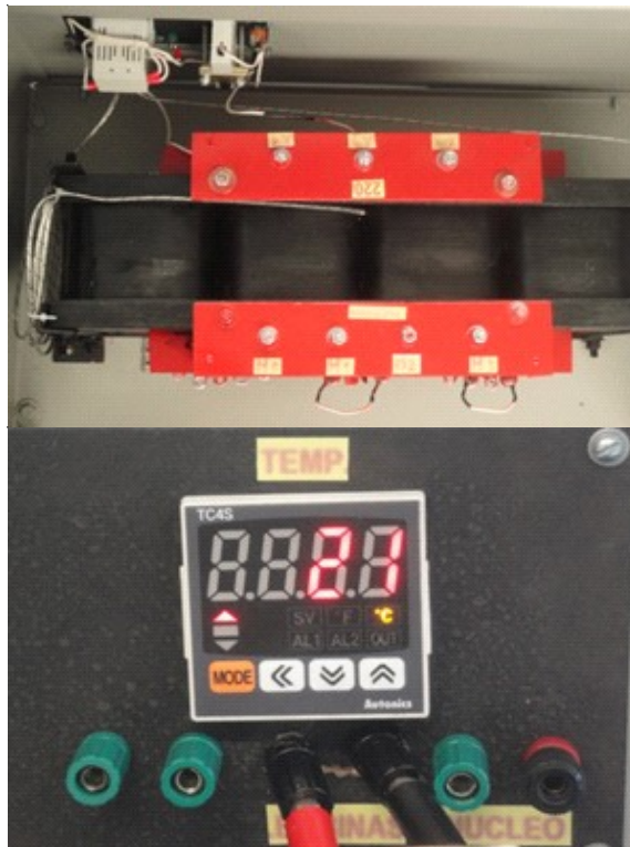
Fig. 2. Termopares en las bobinas y núcleo del transformador.
